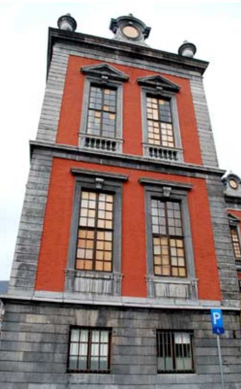
Châssis endommagés de l'hôtel de Ville. Photo D. Preud'homme © SPW
